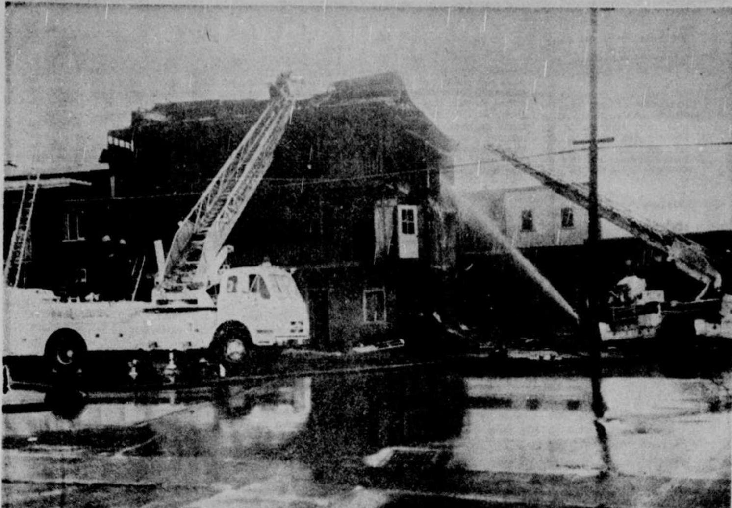
● QUEBEC — Cette maison a été détruite par le feu vendredi après-midi. Sans doute, ce sinistre accélèrera-t-il les opérations de démolition qui étaient engagées dans ce secteur.
